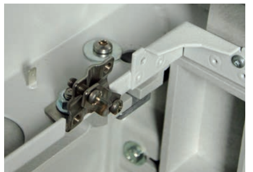
7C Befestigte Erdungsklemme im Zwischensockel.
