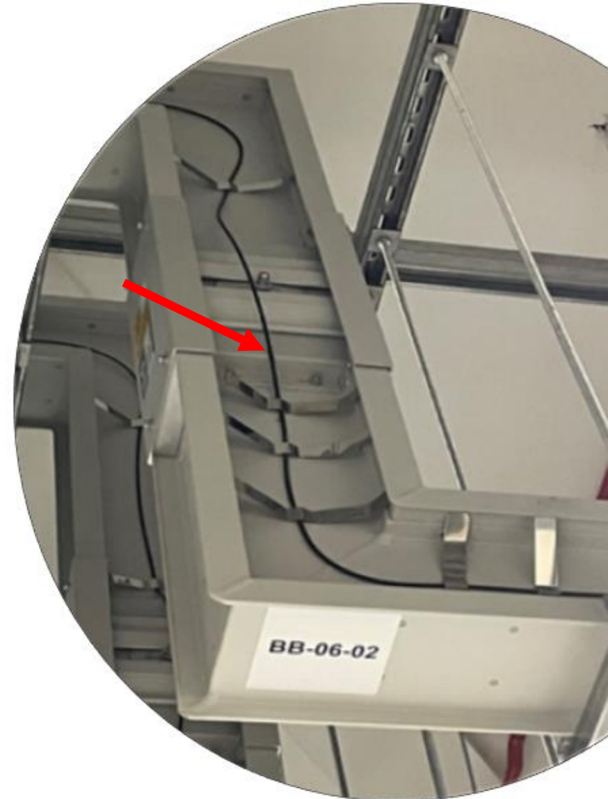
Auf der Sammelschiene verlegtes Sensorkabel
